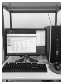
コントロールシステム
